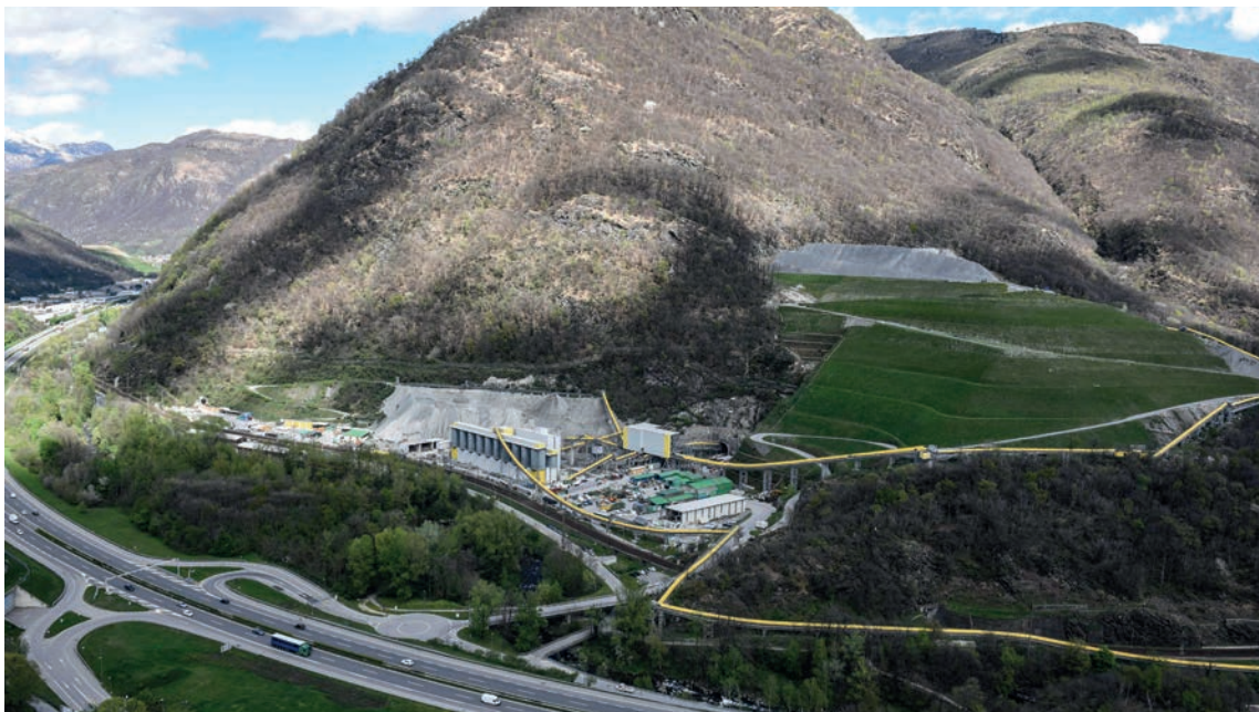
In Sigrino wurde nicht wiederverwendbares Ausbruchsmaterial mit Förderbändern auf die Ablagerung am Fuss des Monte Ferrino transportiert.
